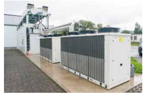
Die modular aufgebaute Wärmerückgewinnung von ONI ist – wie ihr Vorgänger – in Containerbauweise und mit der Kälteanlage gleich neben der Produktionshalle installiert.
